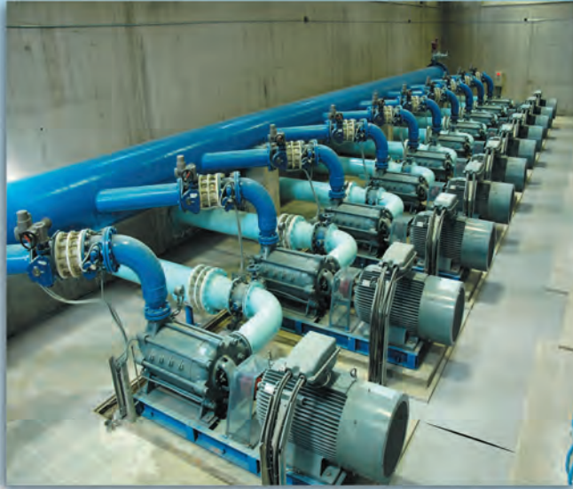
ایستگاه پمپاژ پروژه عمان سامانی
